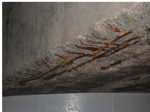
コンクリート部材の損傷
