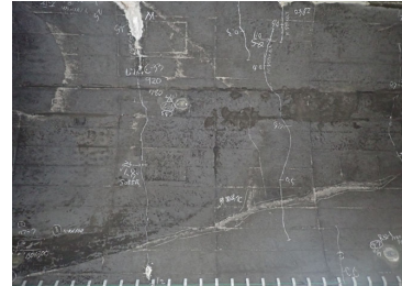
覆工コンクリートのひび割れ
