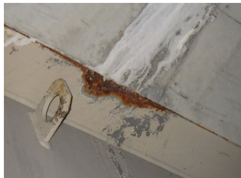
鋼部材の損傷
