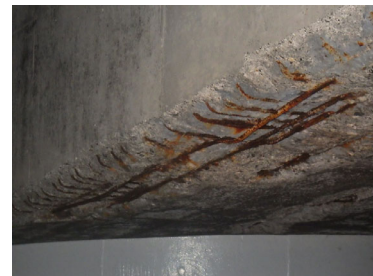
岩大橋（真鶴道路）における損傷状況 （令和8年度以降に修繕実施予定）
