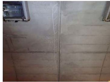
衣笠城趾トンネル（三浦縦貫道路） における変状状況 （令和3年度に修繕実施済）
