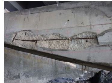
新吉浜橋（真鶴道路）における損傷状況 （令和3年度に修繕実施済）
