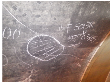
逗葉トンネル（逗葉新道） における変状状況 （令和8年度に修繕実施予定）
