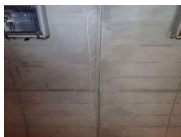
衣笠城趾トンネル（三浦縦貫道路） における変状状況 （令和３年度に修繕予定）
