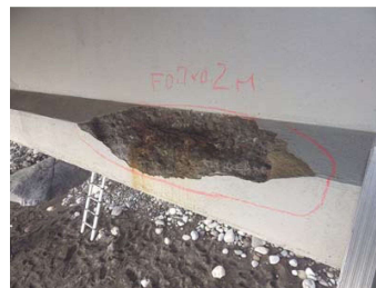
新吉浜橋（真鶴道路）における損傷状況 （令和2年現在対策実施済み）
