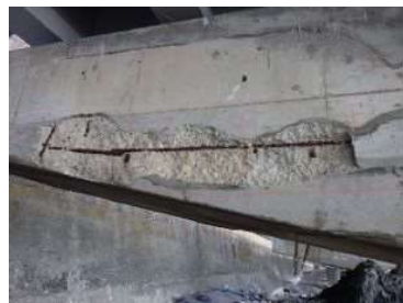
新吉浜橋（真鶴道路）における損傷状況 （令和3年度に修繕予定）
