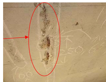
衣笠城趾トンネル（三浦縦貫道路） における変状状況 （令和２年現在対策実施済み）
