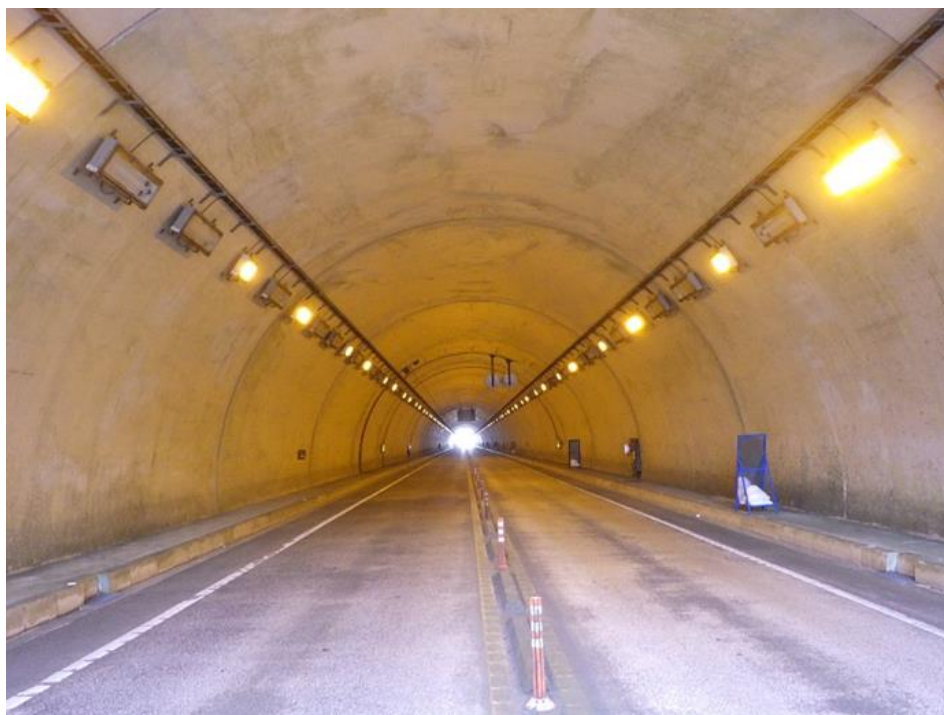
三浦縦貫道路 衣笠太田和トンネル内、照明灯配置状況
